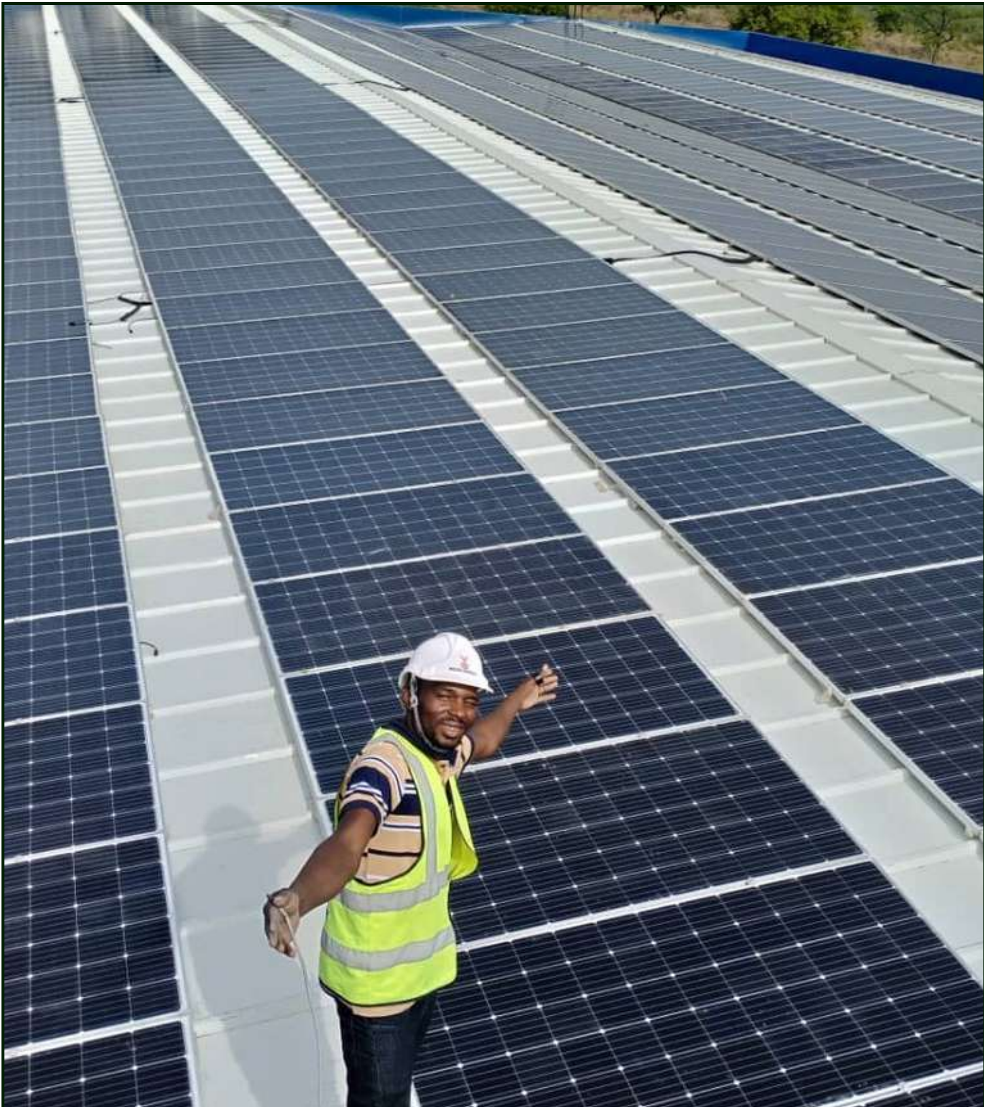
A Nigus Solar PV Farm (500MW+)
